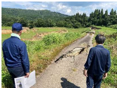
【塩水坂地区地すべり発生】
