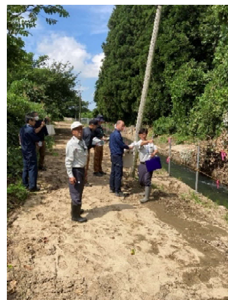
【遊佐幹線水路法面崩落】
