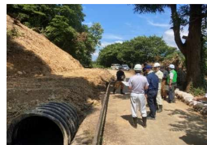
【北楯大堰水路法面崩落】
