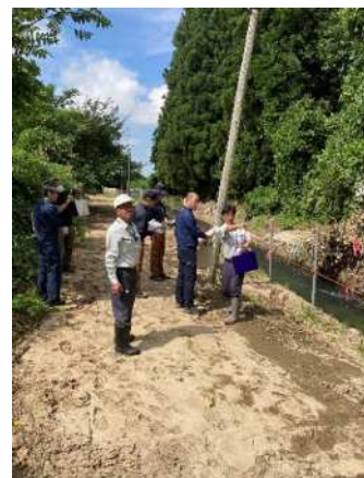
【遊佐幹線水路法面崩落】
