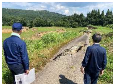
【塩水坂地区地すべり発生】
