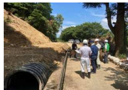
【北楯大堰水路法面崩落】
