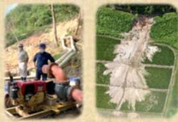
宮崎議員の白川・長堀堰視察 (令和4年8月豪雨災害)
